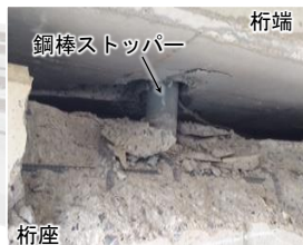
写真-1 損傷事例
