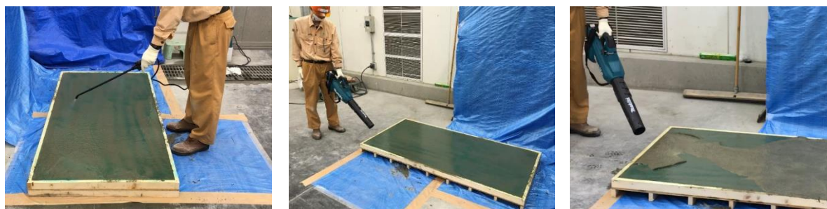
写真-3 アルギン酸ナトリウム水溶液の散布状況(左)と生成した不溶性ゲルのブローによる除去状況(中, 右)
