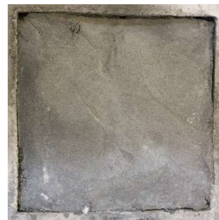
写真-4 施工後に断面修復の垂れが見られた断面修復箇所の一例
