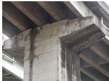
写真-1 橋脚部の ASR による劣化状況
