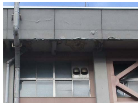
写真-2 建築構造物の軒部の劣化状況
