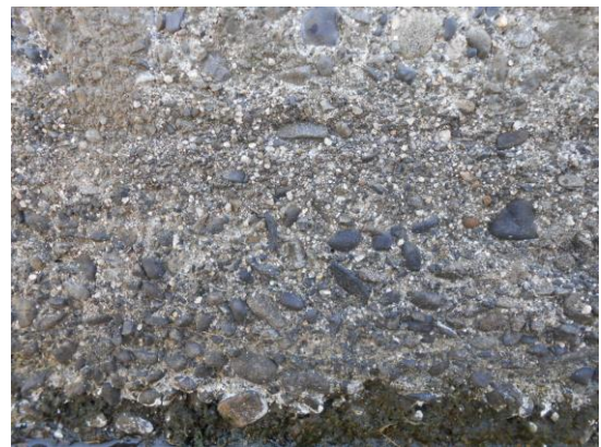
図-1 摩耗と溶脱の複合作用で表面粗さが増加した水路コンクリート壁面
