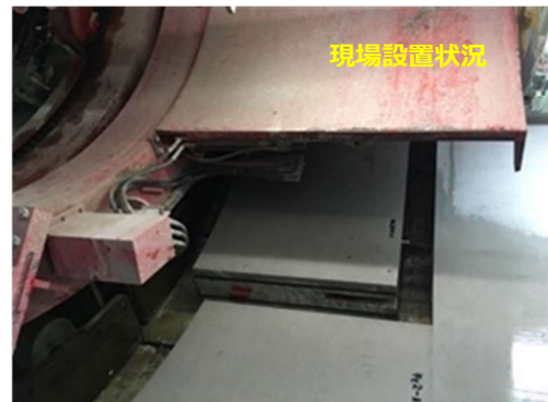
写真-6 環境配慮コンクリートのセメント・ゼロ型の現場設置状況
