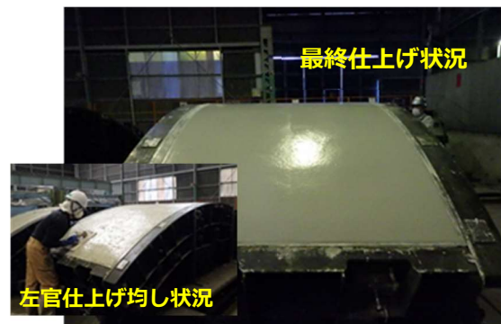
写真-5 環境配慮コンクリートのセメント・ゼロ型の仕上げ状況
