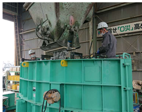
写真-7 環境配慮コンクリートのセメント・ゼロ型の打込み状況
