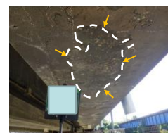
チタン被膜剥離状況
