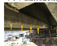
断面修復部の境界
