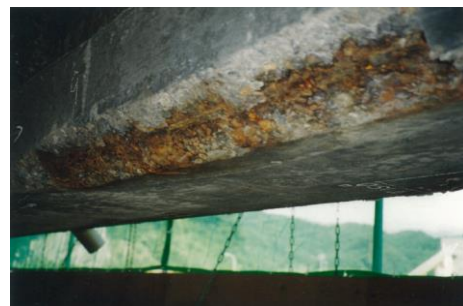
図-2 電気防食導入前の主桁劣化状況（1998年）
