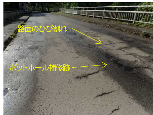
写真-1 凍結防止剤が散布された道路橋の路面損傷 (国道 158 号, H 橋)
