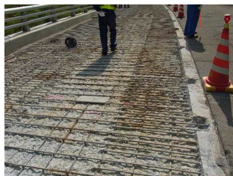
写真-5 RC床版の車両走行位置での上側鉄筋の腐食状況 (国道 157 号, B 橋)
