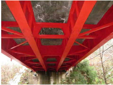
(a) 床版パネルによる劣化の相違
