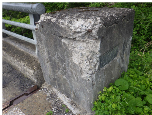
写真-6 親柱に発生したASRおよび凍害による ひび割れと表面剥離(国道158号)
