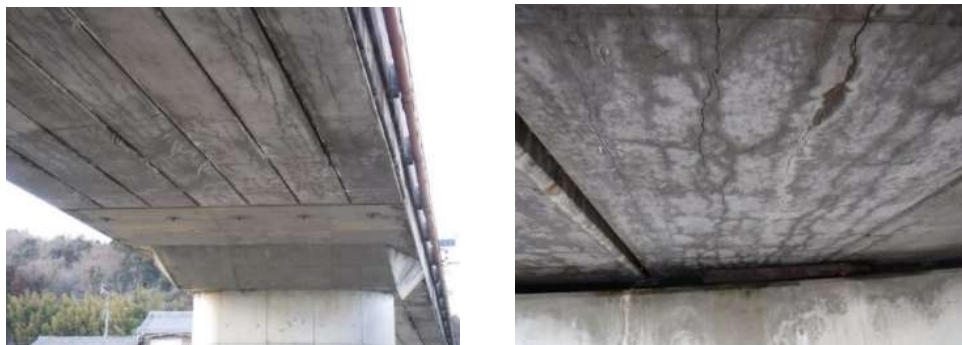
写真－1 佐那具橋桁下面の劣化状況
