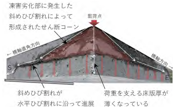
写真-6 斜めひび割れの発生によって形成されたせん断コーンが薄いスラブを押し抜こうとする
