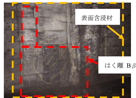
写真-8 表面含浸材塗布箇所の中壁部はく離 (B線 13k556m)
