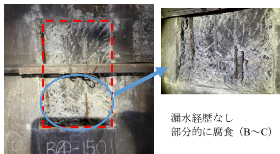
写真-14 はつり調査による鉄筋腐食(B線 17k058m)
