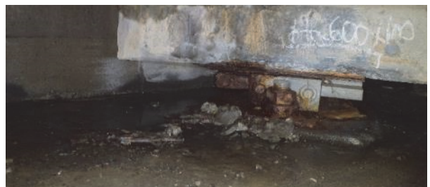
写真-2 橋座面の滞水による支承の腐食
