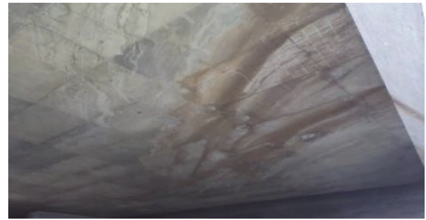
写真-3 主桁下面の伝い水
