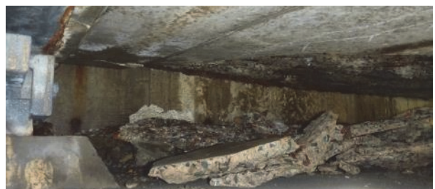
写真-1 塩害による主桁下面コンクリートの剥落
