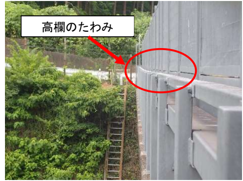
写真-2 馬乗石橋高欄にみえるたわみ (南側より，名古屋側)
