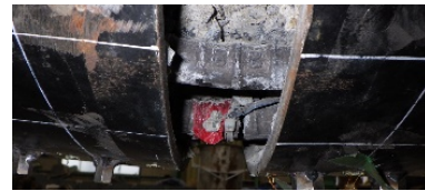
【D-1, 破壊状況 (下縁引張側の鉄筋破断)】
