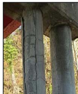
(1)パイルベントの損傷
