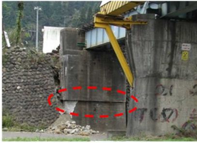
写真-1 新潟県中越地震で変状した 無筋コンクリート橋台前面の状況 3)
