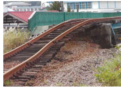
写真-2 新潟県中越地震で変状した 無筋コンクリート橋台背面の状況 3)
