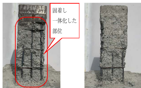
下面(フランジ) 前面(ウェブ) (b)R20-0-PP1'の増し打ちコンクリート除去後状況
