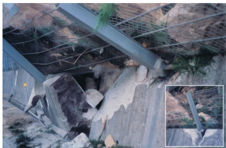
写真-1 落石防護擁壁の損傷例
