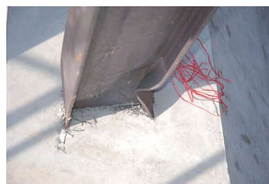
写真-4 実験終了後における支柱の基部の変形状況
