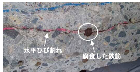
図-2 損傷した RC 床版の切断面の一例
