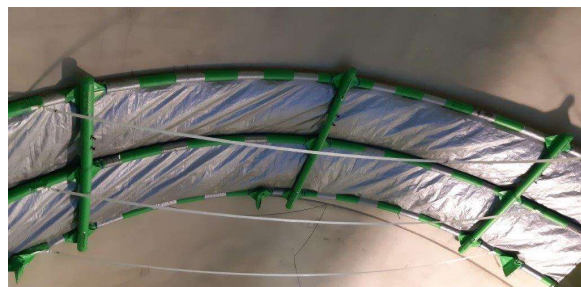
写真-4 養生シートがトンネル天端部に押し当てられている状況
