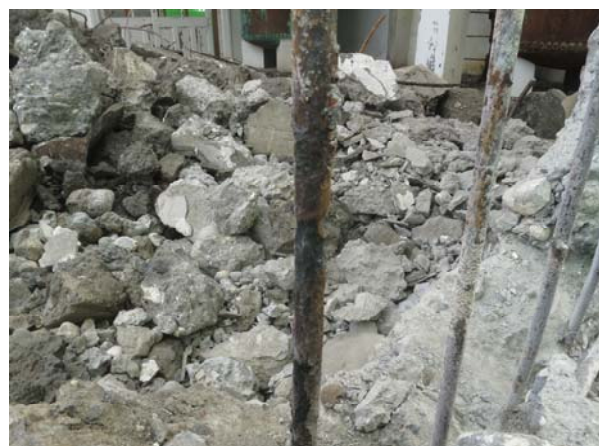
(d) 矢印Bの鉄筋の腐食状況(腐食グレードⅤ)
