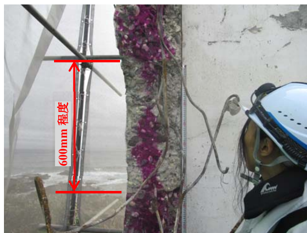
写真-3 フェノールフタレイン溶液噴霧による コンクリート断面の呈色状況
