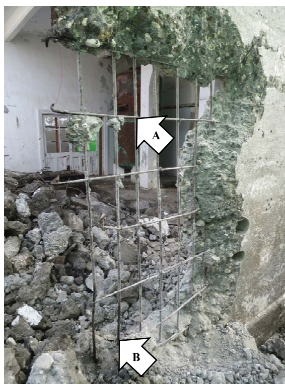
(b) 解体後の外観
