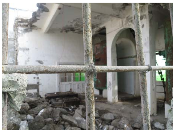
(c) 矢印Aの鉄筋の腐食状況(腐食グレードⅠ)
