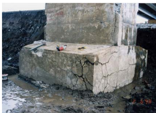
写真-1 ASR 発生構造物の状況
