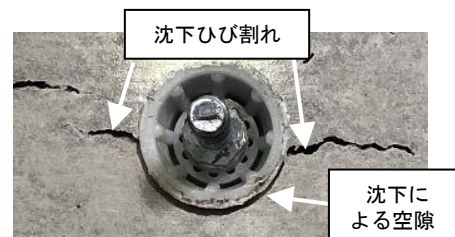
写真-1 P コーン部の沈下
