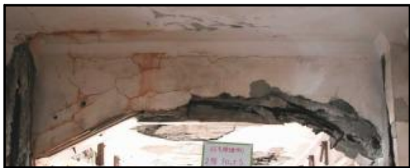
写真-11 錆汁痕の例(65号棟)
