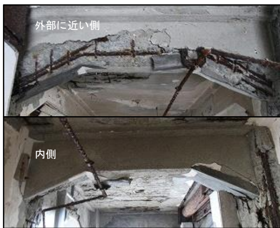
写真-10 同一梁の両面の劣化度比較例(65号棟)
