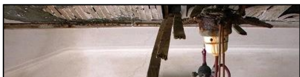
写真-5 5階住戸間の境界位置の梁(劣化程度は軽微)
