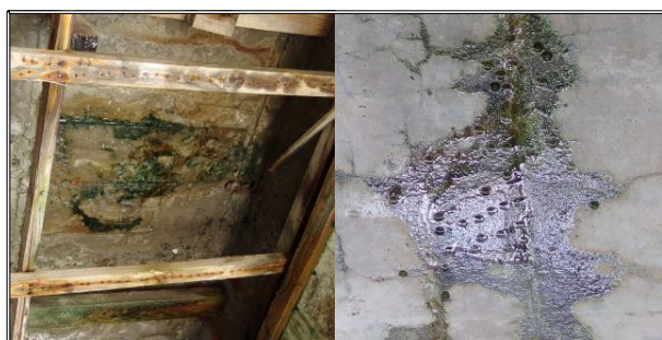
写真-3 天井面の漏水
