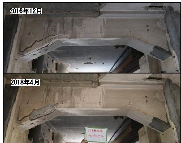
写真-13 劣化がみられるが判定は変わらない箇所の例(65号棟 東棟 ブロック4-5間)
