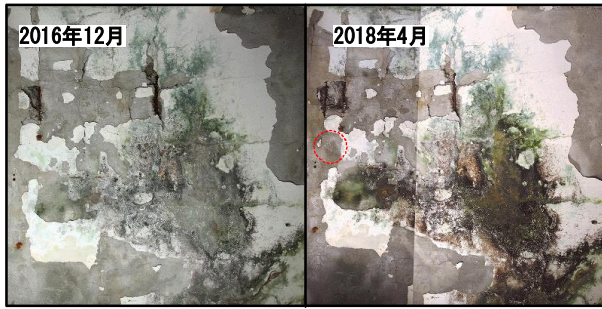
写真-8 劣化がみられるが判定は変わらない箇所の例 (2階 部屋4 居室右側天井)
