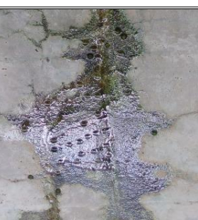
写真-4 天井面から落下する水滴
