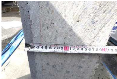
写真-11 試験体切断面 (健全部隙間 15mm)
