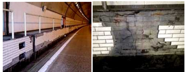
写真-1 監視員通路縦壁の劣化・損傷状況
