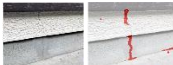
図-7 基礎コンクリートのひび割れ検出結果
