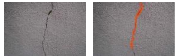
図-5 モルタル系外装材のひび割れ検出
