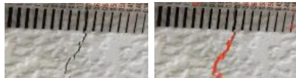
図-6 窯業系サイディングのひび割れ検出結果
