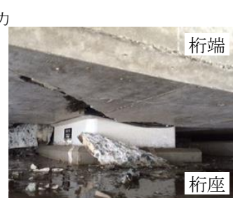
写真-1 損傷事例
