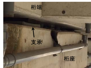
写真-3 実橋の鋼棒ストッパー前面の損傷状況 6)
