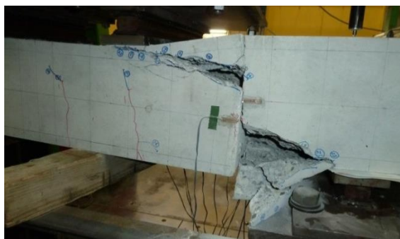
写真 - 7 試験体 4-2 壊状況
