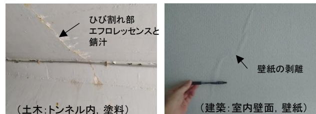
写真-1 表面仕上材が施工されたコンクリートへのひび割れの発生
