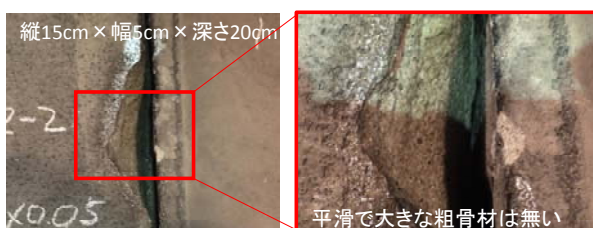
写真-2 目地部のはく離事例
