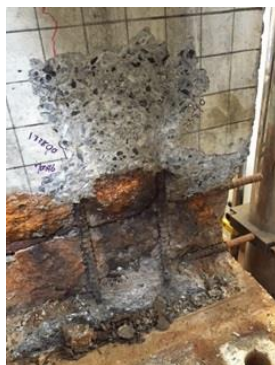
図-4 10-W の北面の損傷状況(載荷試験終了時)
