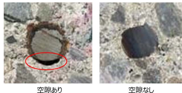
図ー6 ブリーディングにより生じた空隙の例
