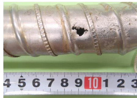
図-14 No.1 腐食貫通孔拡大(除錆後)
