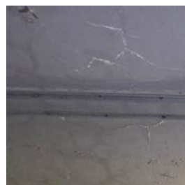
写真-9 再劣化状況
