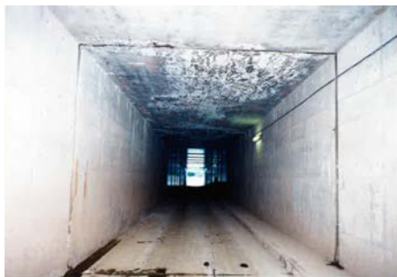
写真-6 補修前の状況 (建設後 20 年)
