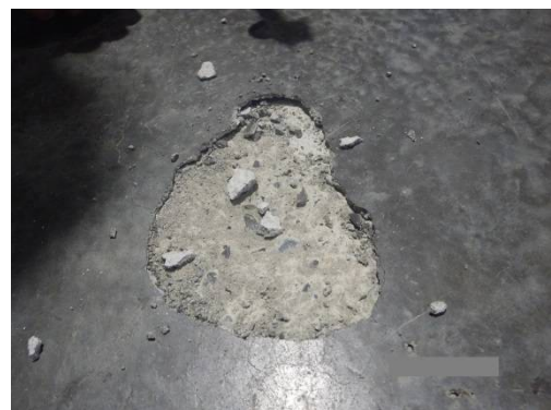
写真-1 表面剥離の状況
