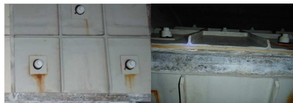
(c) ボルトキャップからの錆び汁の拡大写真 (d) 特殊バックフィルの流出 拡大写真
