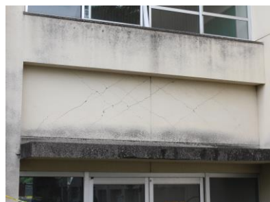
写真-2 垂壁のせん断ひび割れ
