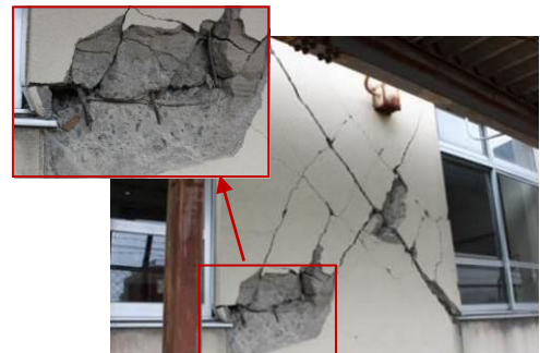
写真-3 方立壁損傷状況
