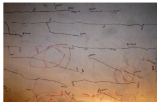
写真-4 FRP 格子筋埋設型工法のひびわれ
