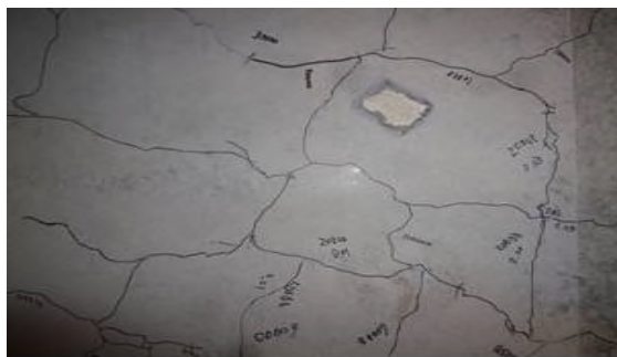
写真-1 補強前ひびわれ
