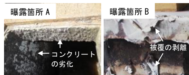
写真-1 曝露環境における硫酸劣化の様子
