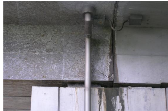
写真-6 ASRによる変形によりPC桁の端部に発生したひび割れ(定着体の破壊)
