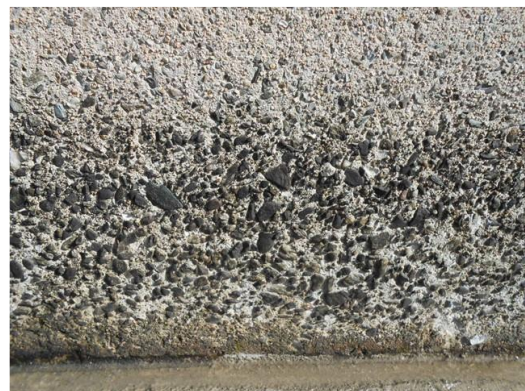
図-1 粗骨材の露出が生じた水路コンクリート壁面
