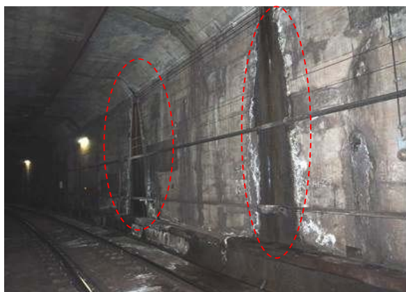
図-1 トンネル漏水部
