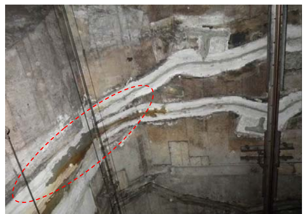
図-2 再漏水箇所
