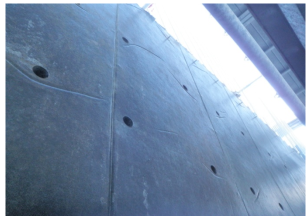
写真-4 透水型枠使用箇所に生じたしわ痕
