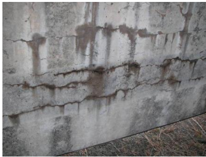
写真-15 広域変成岩による被害事例（九州地方）
