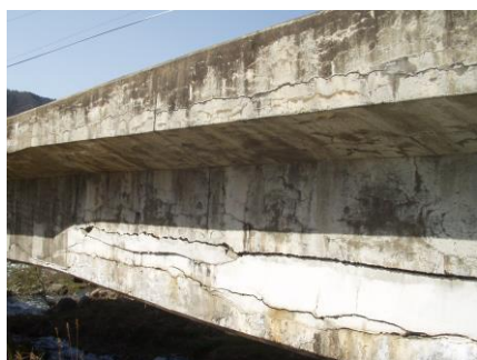
写真-6 火山岩類による被害事例（山陰地方）
