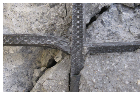
写真－４ CFG 板横筋のせん断変形（□1）
