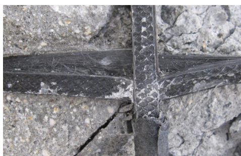
写真－５ CFG 板横筋の繊維方向の割れ裂け（□2）
