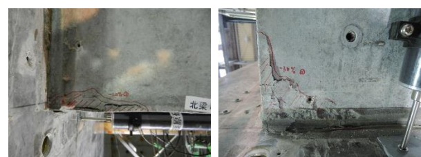
図-4 軽微なコンクリート圧壊状況 ( R=1.0\% )
