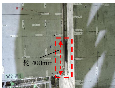
図-5 南側梁の目地部剥落状況 (R=2.0%)
