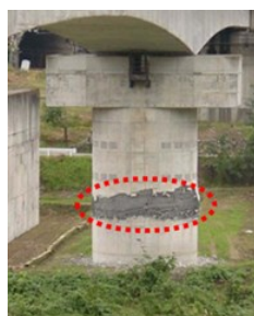
図-1 地震時に損傷した RC 橋脚事例
