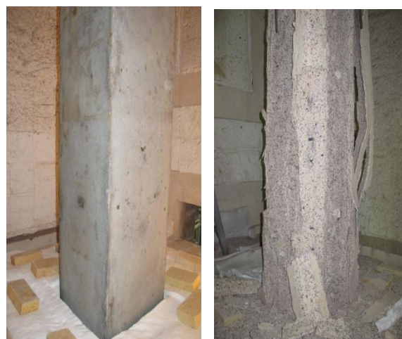
a) 加熱前(爆裂無) b) 加熱実験終了後 図-5 鉄筋コンクリート柱の爆裂性状
