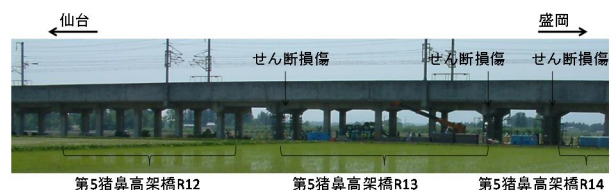
図-1 2003 年三陸南地震による岩手県猪鼻高架橋 (RC1 層ラーメン) の地震被害
